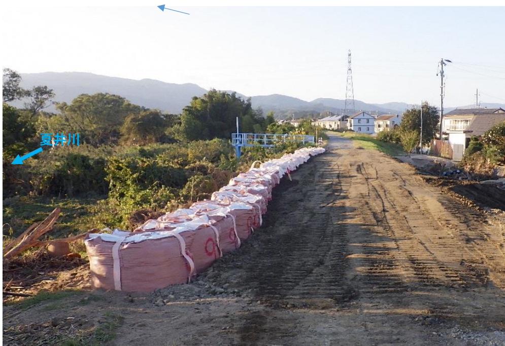
被災状況 (令和元年10月18日撮影)
