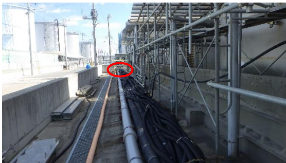
(写真2-1) H9タンクエリア北側の配管敷設状況 西側から撮影 赤丸部分が外堰貫通部分 シルバーの配管は撤去予定外の配管
