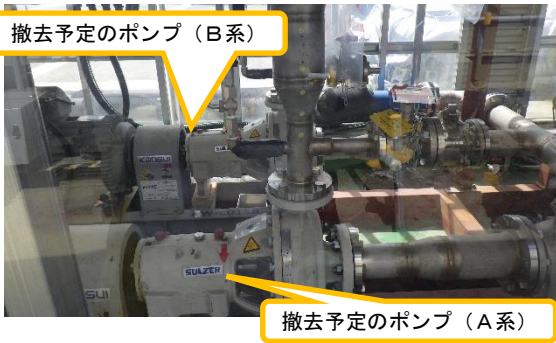
(写真1-2) 濃縮処理水移送ポンプ室内部の状況
