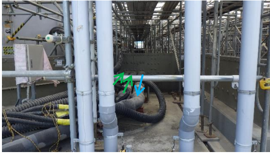
(写真2-3) H9タンクエリア西側及びH9西タンクエリア東側の配管敷設状況 北側から撮影
