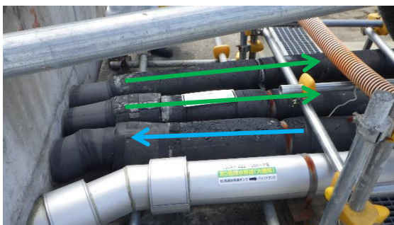
(写真2-2) 外堰貫通部分拡大 矢印は流れ方向 (以下同じ)
