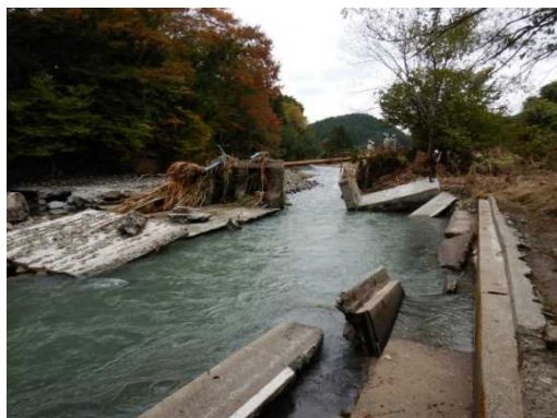
堰本体及び護岸に甚大な被災を受け 取水が困難な『岡の内堰』
