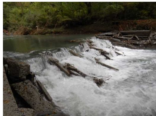
堰本体及び護岸に甚大な被災を受け 取水が困難な『五ヶ市堰』
