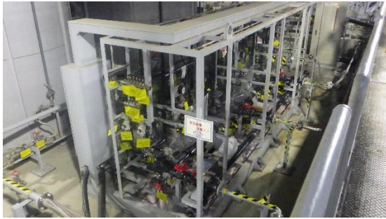
(写真1-1) 増設多核種除去設備 塩酸供給ポンプスキッド
