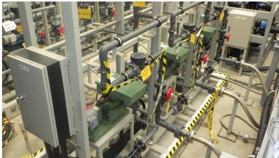
(写真2-1) 既設多核種除去設備 塩酸供給ポンプスキッド
