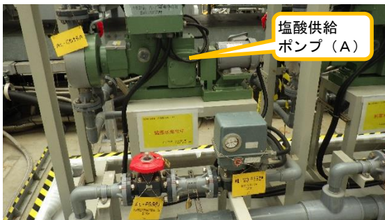
(写真2-2) 既設多核種除去設備 (A) 塩酸供給ポンプ (A) 付近の状況
