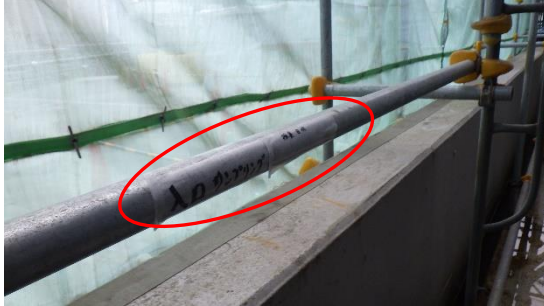
(写真4-1) (写真2-1)の出入り口付近に堰内雨水サンプリング箇所である旨の表示(赤丸)があった。
