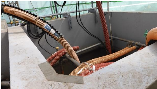
(写真4-2) 内堰内雨水集水ピット
