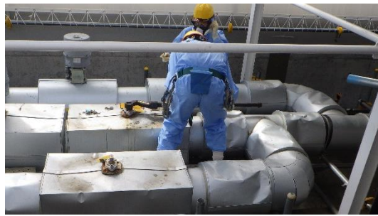
(写真 1 - 2) Gr - 3の排水ラインの弁開操作の状況
