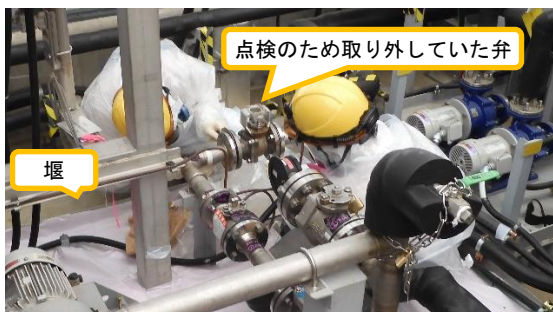
(写真 1 - 2) 漏えい箇所の状況
