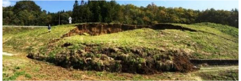
農地法面の崩落 (葛尾村)
