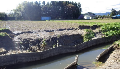
排水路の被災 (南相馬市)
