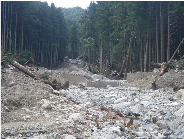
治山施設の大規模損傷（南相馬市）
