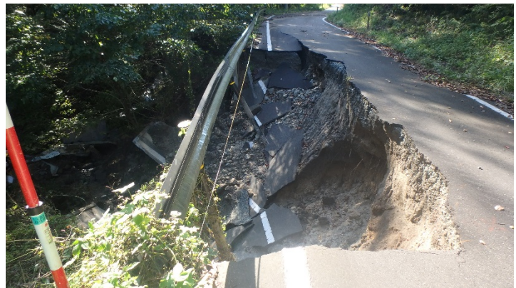
林道路肩の決壊 (川内村)
