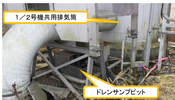
(写真1-2) ドレンサンプピットの状況
