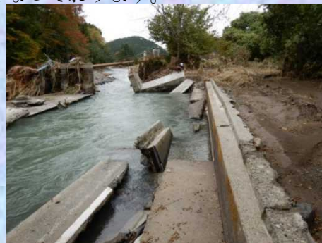
頭首工（堰）の流失
