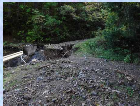
林道の路体崩壊
