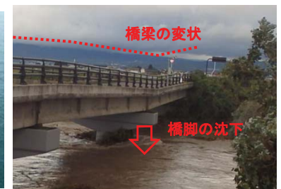
会津若松三島線（会津若松市） 【道路の被災状況】
