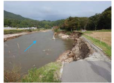
木戸川（川内村） 【河川護岸の被災状況】
