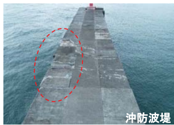
小名浜港（いわき市） 【港湾の被災状況】
