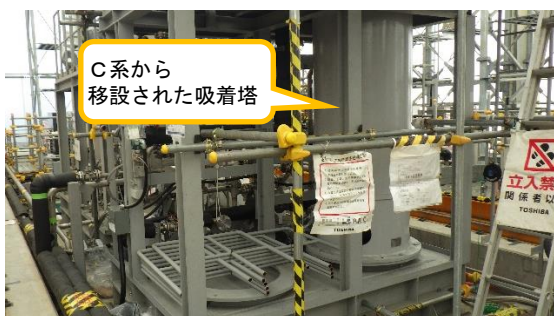
(写真 1 - 1) A系の吸着塔ラック
