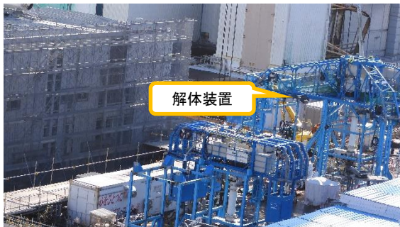
（写真2-2） 2号機原子炉建屋西側ヤードの状況
