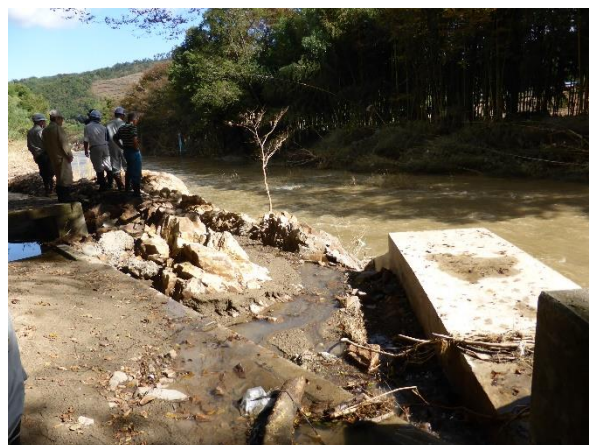
砂子堰水路構造物の破損
