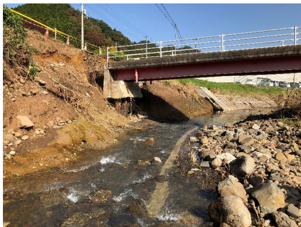
河川護岸が流出し基礎が露出した農道橋(福島市)
