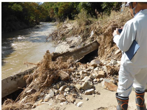
河川の越水による砂子堰水路の倒壊
