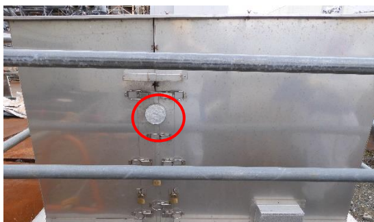
(写真3) No. 49ピットの配管接続部分（赤丸部分が配管接続部分）
