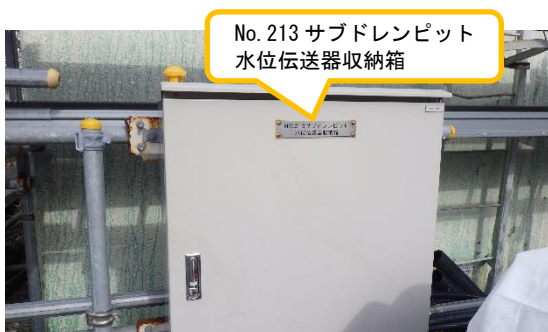
(写真4-3) No. 213ピットの水位伝送器収納箱 No. 49ピットについては当該収納箱 は未設置
