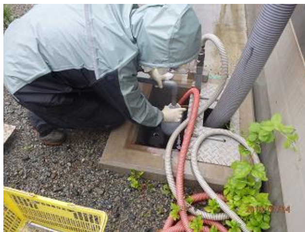
土壤貯蔵施設シート下部湧水の測定
