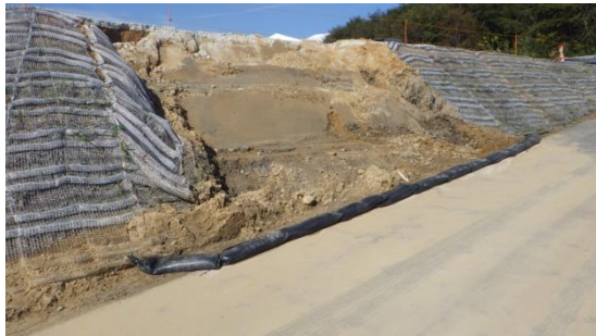
(写真1-2) 法面が崩れた箇所の拡大写真
