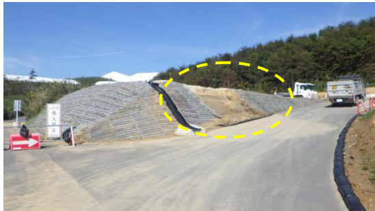
(写真1-1) 黄枠部分：法面が崩れた箇所
