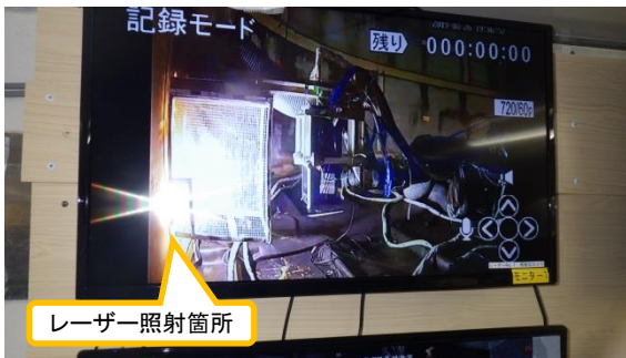
(写真2) 遠隔操作室モニタ
