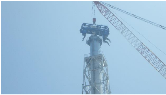
(写真 2 - 1) 旋回作業の状況 解体装置が排気筒直上部から離れて、時計回りに旋回している
