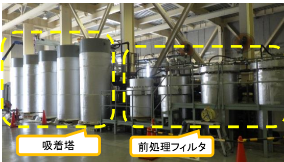
(写真1-2) サブドレン他浄化設備 (B系側)
