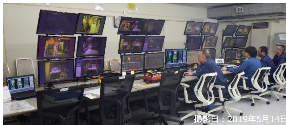
遠隔操作室の状況
