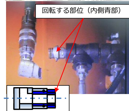
○部拡大：漏えい箇所
