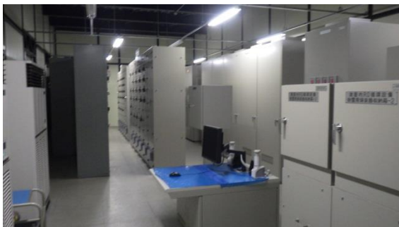
(写真1-2) 電気品室内部
