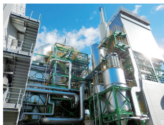
製紙会社ボイラー
