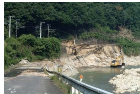
鉄道の被害状況 （広島県東広島市 JR山陽線）
