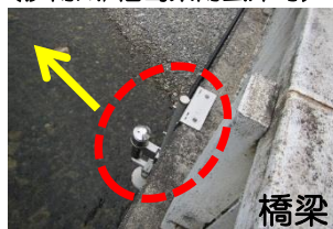
橋梁 浜野雨量水位観測局 超音波式水位計 (伊南川/福島県南会津町)
