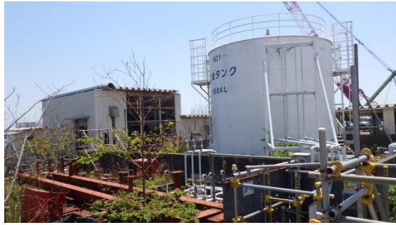
(写真3) 軽油タンク
