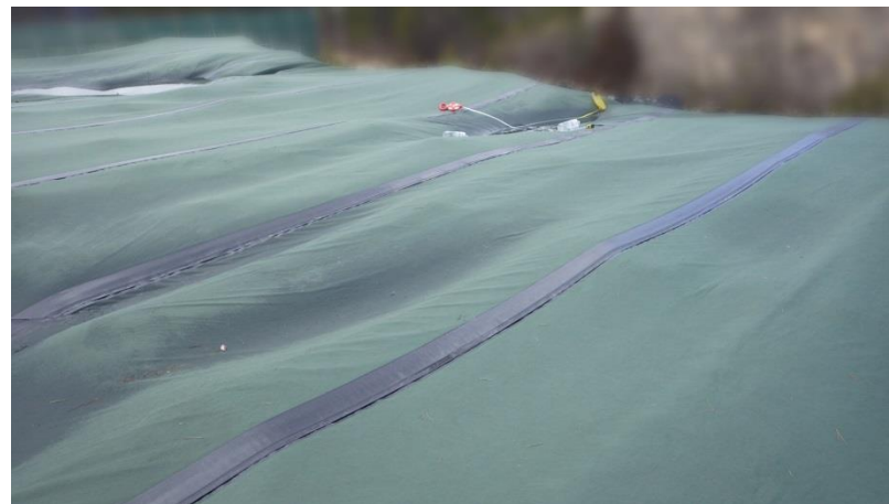
施工8週後の不陸発生状況（2017.3.14）
