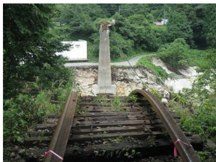
流出した第六只見川橋梁 (金山町)
