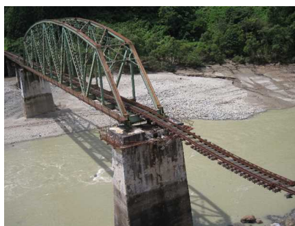
流出した第五只見川橋梁 (金山町)
