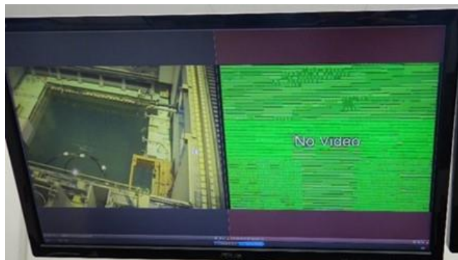
画像の乱れ状況
