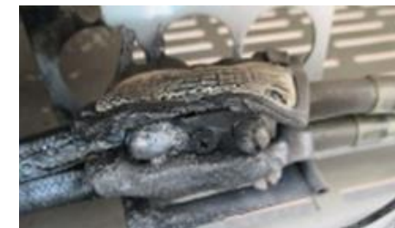
ブレーキレジスタ内の損傷（5月12日）
