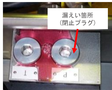
漏えい箇所特定状況
