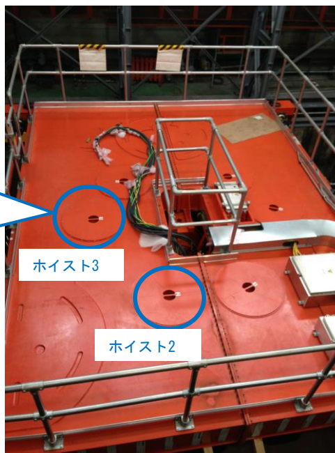
燃料取扱機トロリ上部
