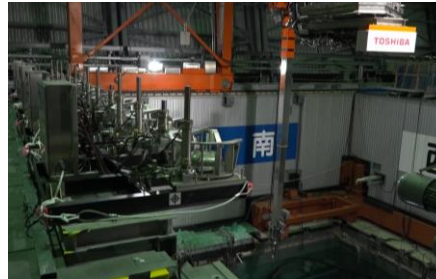
オペレーティングフロアの様子
