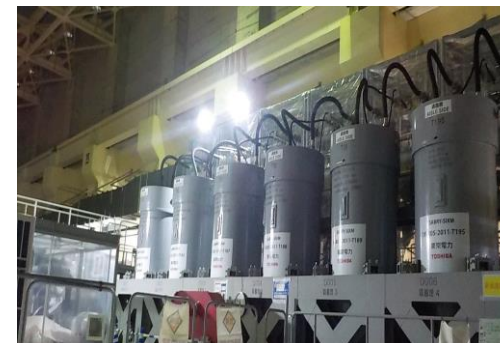
第三セシウム吸着装置 ろ過フィルタ及び吸着塔
