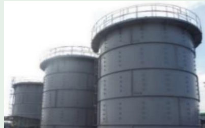
フランジ型タンク
