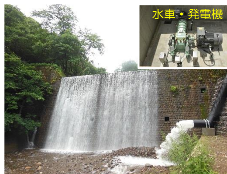
土湯温泉東鴉川水力発電所（福島市）
