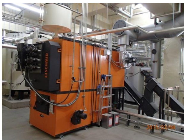
木質チップボイラー(西会津小学校(西会津町))
