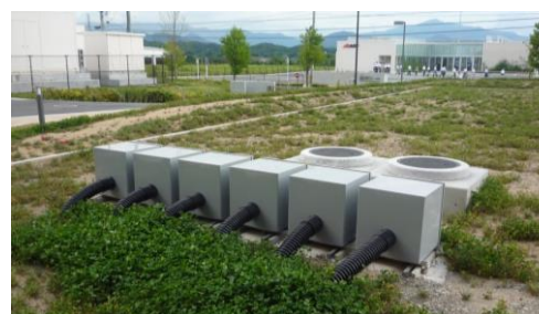
地中熱の研究開発 （郡山市 福島再生可能エネルギー研究所）
