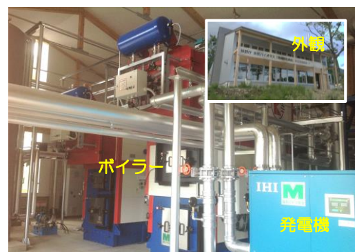
南会津高原 地域熱供給実証事業施設（南会津町）
