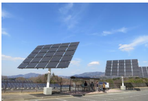
福島空港メガソーラー（須賀川市／玉川村）
