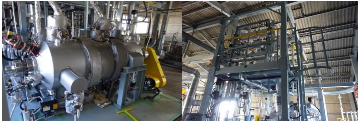
パイロットプラント
