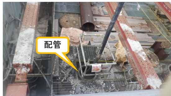
(写真2-2) 3槽目のピットの配管内に生コンを打設している様子②
