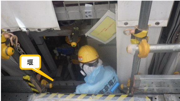
(写真1-1) 漏えい確認の状況① 堰内の床面に水溜まりが確認された。
