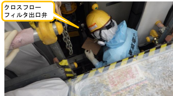
(写真1-2) 漏えい確認の状況②
