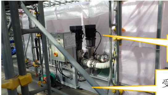
(写真2-1) 仮設のポンプユニット
