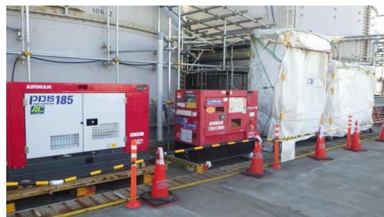
(写真 3 - 2) 移設予定の発電機
