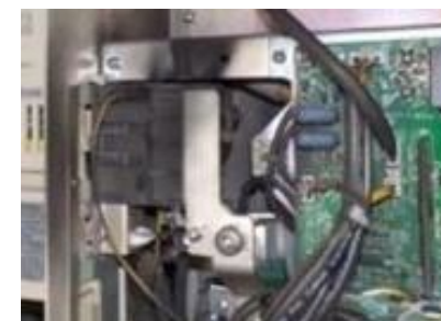
主巻インバータ内部の煤
