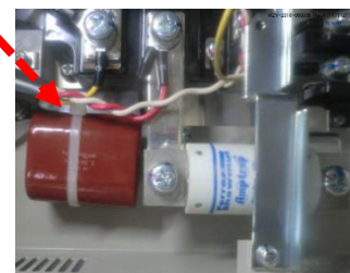
損傷の確認されたヒューズ (4月25日)
