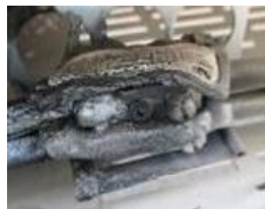
ブレーキレジスタ内の損傷
