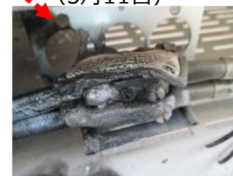
ブレーキレジスタ内の損傷 (5月12日)
