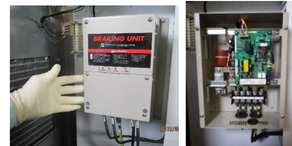
ブレーキユニット表蓋を外した状態
