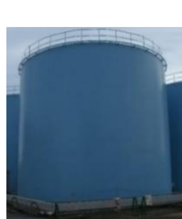
溶接型タンク
