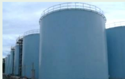
溶接型タンク
