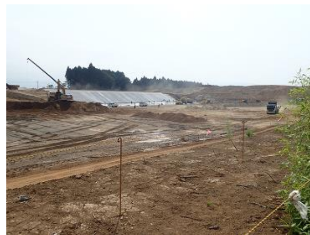
土壌貯蔵施設の稼働状況の確認
