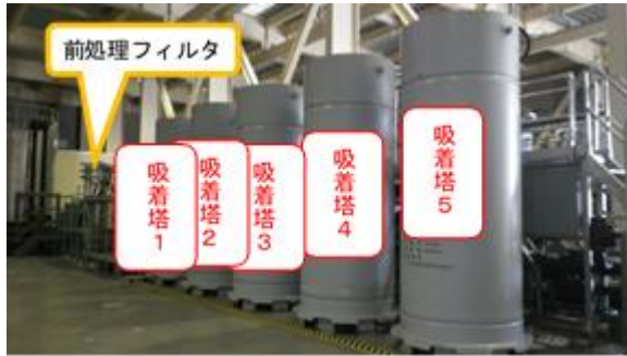
(写真2) サブドレン他浄化装置A系の状況 (建屋内の北西側から撮影) 吸着塔 1～3 : Cs・Sr 吸着塔 吸着塔 4 : Sb 吸着塔 吸着塔 5 : 重金属塔
