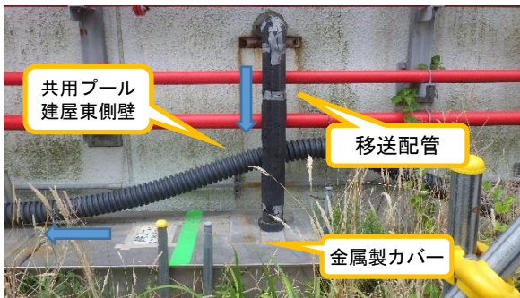
(写真2-1) 移送配管の敷設状況③ (共用プール建屋東側壁出口配管) ※東京電力によると、当該箇所は鋼管であり、外力に強いことから金属製カバーを設置していないとのことであった。また、今年度中に配管の交換を実施する予定とのことであった。
