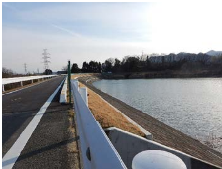
施設災害復旧事業(23年災) 家老地区(富岡町) ため池復旧工事 竣工写真(平成30年2月撮影)
