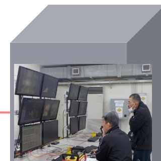
遠隔操作室 (事務本館)
