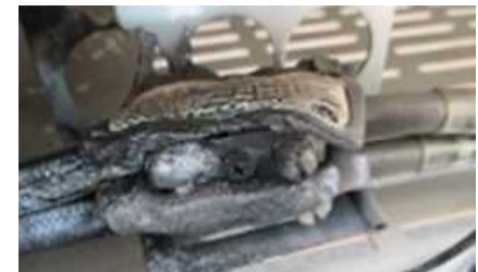
ブレーキレジスタ内の損傷（5月12日）
