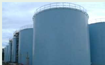
溶接型タンク
