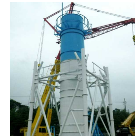
排気筒模擬施設
