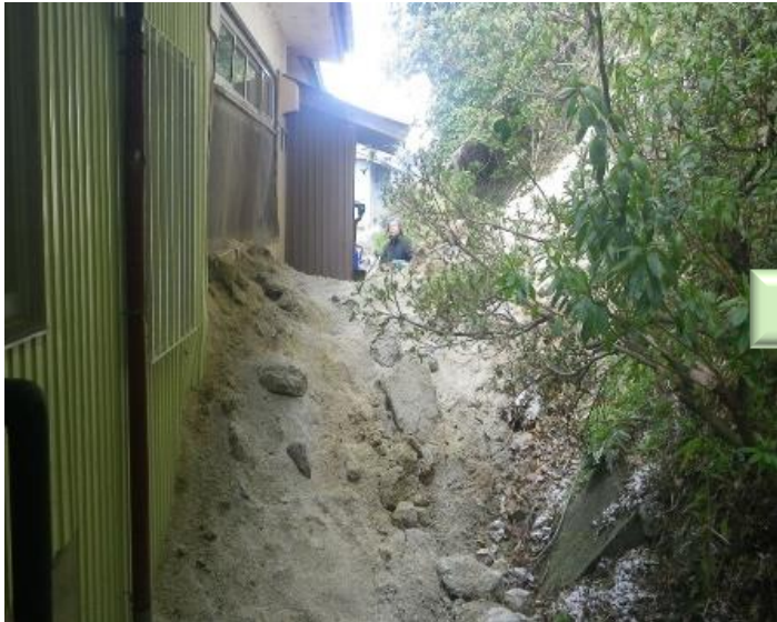
H27.9 関東・東北豪雨による崩落
