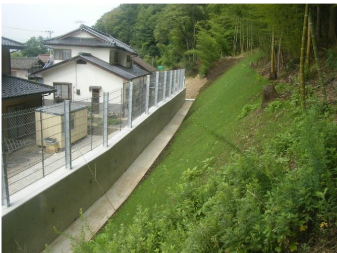
待受擁壁工（羽根山地区）[福島市大笹生]
