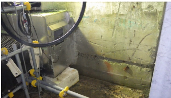
(写真1) 漏えい検知器を格納している容器
