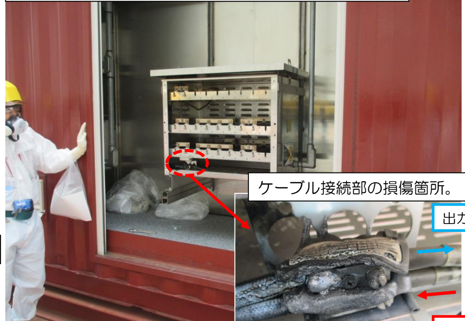
ブレーキレジスタ（クレーン制御盤背面）
