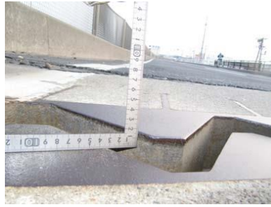
伸縮装置の段差
