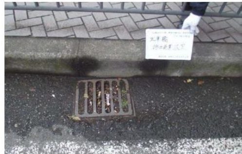
排水ますの土砂詰まり
