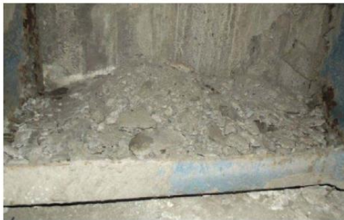
支承付近の土砂堆積
