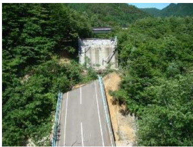
下部工の移動等に伴う、桁全体の圧壊
