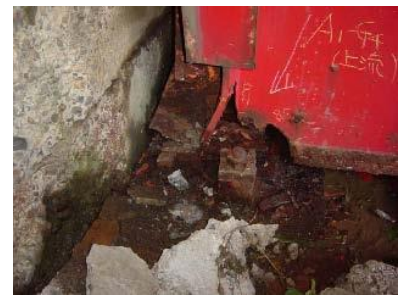
腐食した桁端部で、桁のき裂、破断、鉛直補剛材の変形
