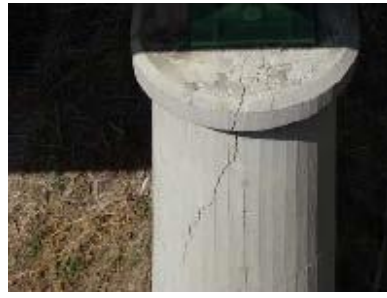
支承部近傍につながるひびわれ
