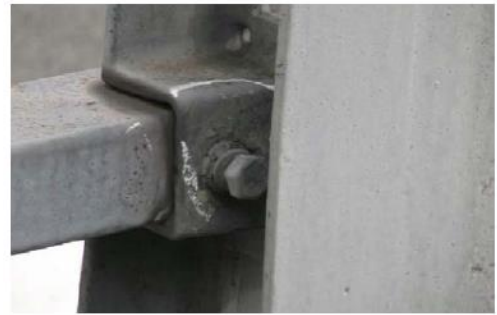
高欄・防護柵ボルトのゆるみ
