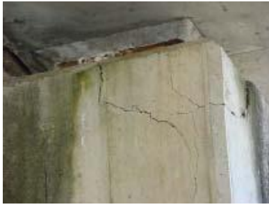
支承部近傍につながるひびわれ
