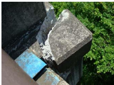
不安定なコンクリート塊
