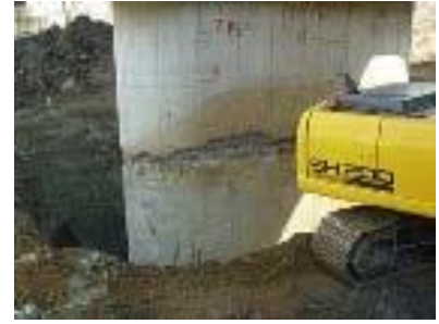
地中部（フーチング）に深く連続している可能性のあるひびわれ
