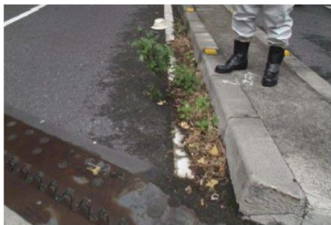
路面の土砂堆積
