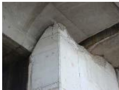
コンクリートのうき、剥離
